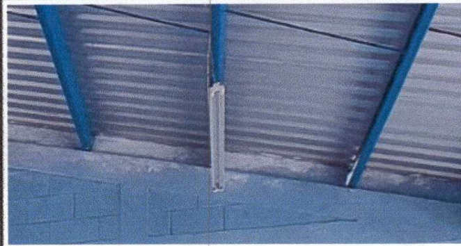
Foto 8: Sustitución de lámpara tipo LED
